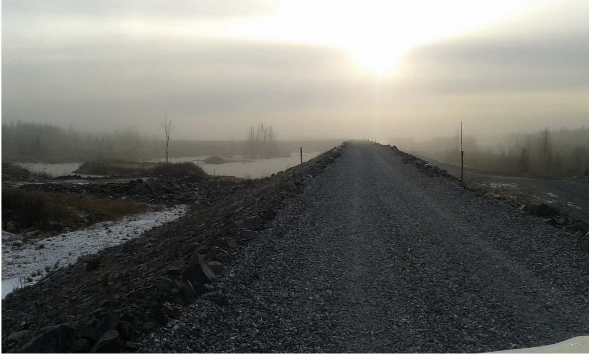
10. Kuvassa patoalueella runsaasti pölyä. Ilmoitettava Yaran asiantuntijoille, jotta pölyn torjuntaa liittyvät toimenpiteet voidaan käynnistää.
