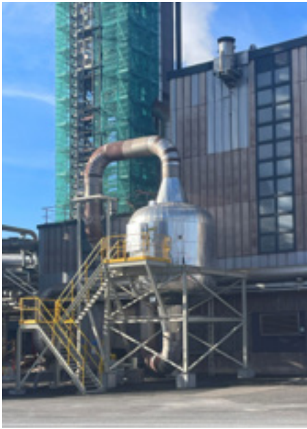
DeNOx-reaktori on kuvassa keskellä oleva kiiltävä säiliö.
